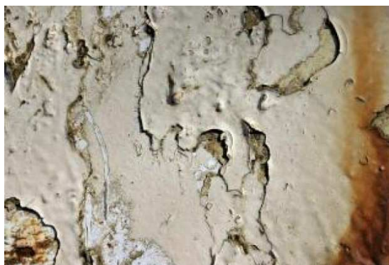
Figura 7: Detalhe da pintura de uma das colunas internas Autoria: Sandra C. A. Pelegrini
